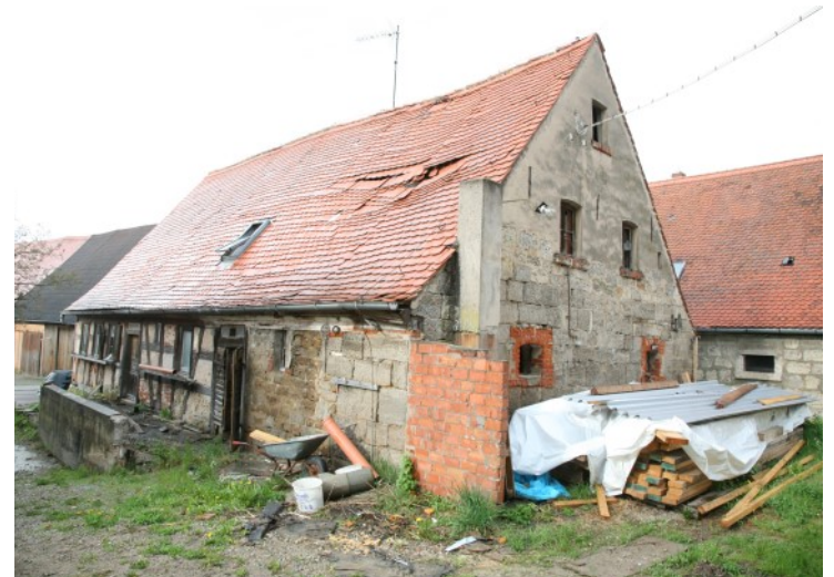
© (E. Knoll) Wohnstallhaus mit beschädigtem Stallteil
