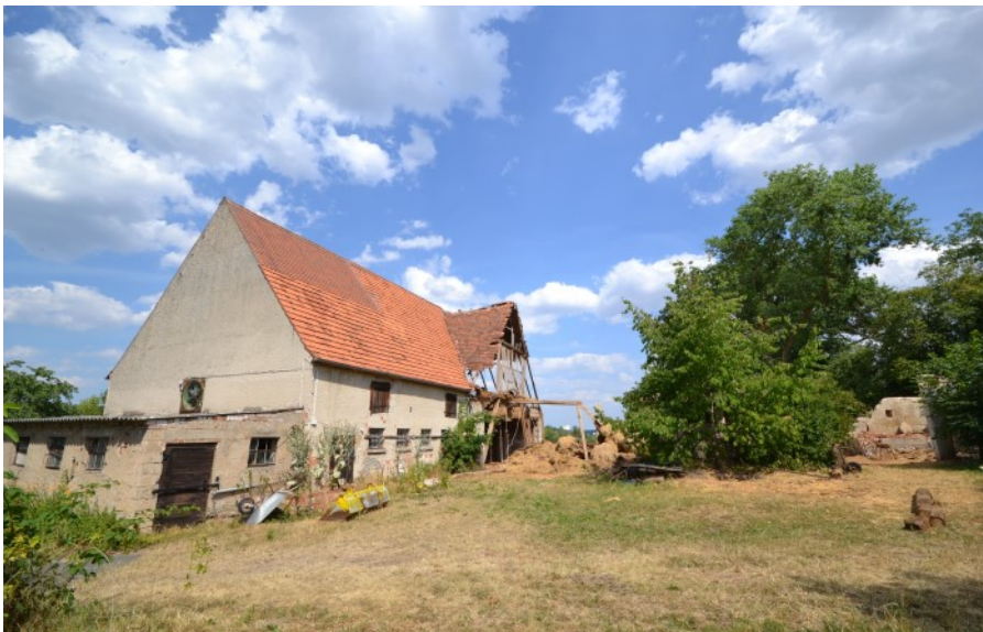
© (G. Gronauer) Stallgebäude mit teilweise eingestürzter Scheune
