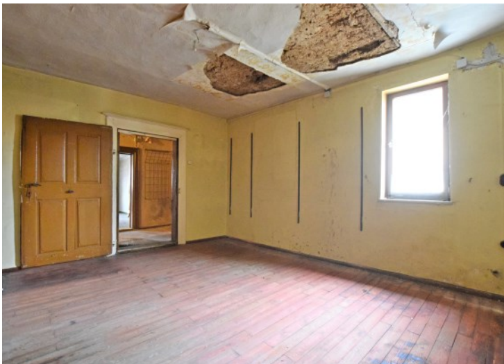
© (Ch. Heitzer) Sanierungsbedürftiger Wohnraum
