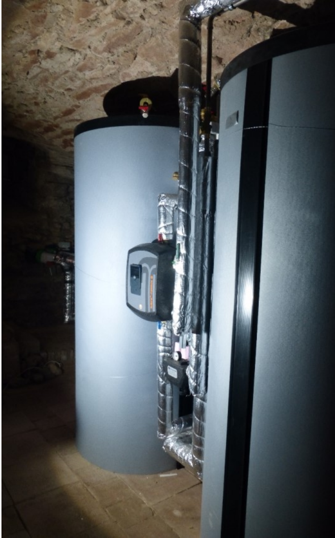
© (E.d.A.) Neu angebrachte Zentralheizung
