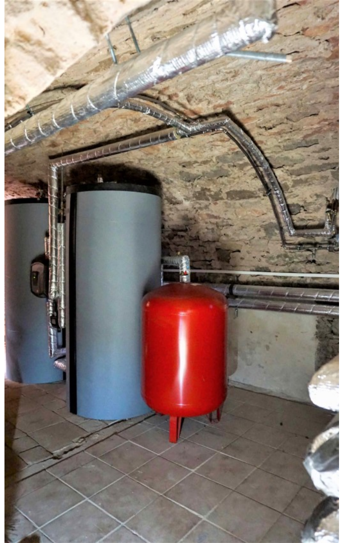
© (E.d.A.) Nahwärme - Zentralheizung
