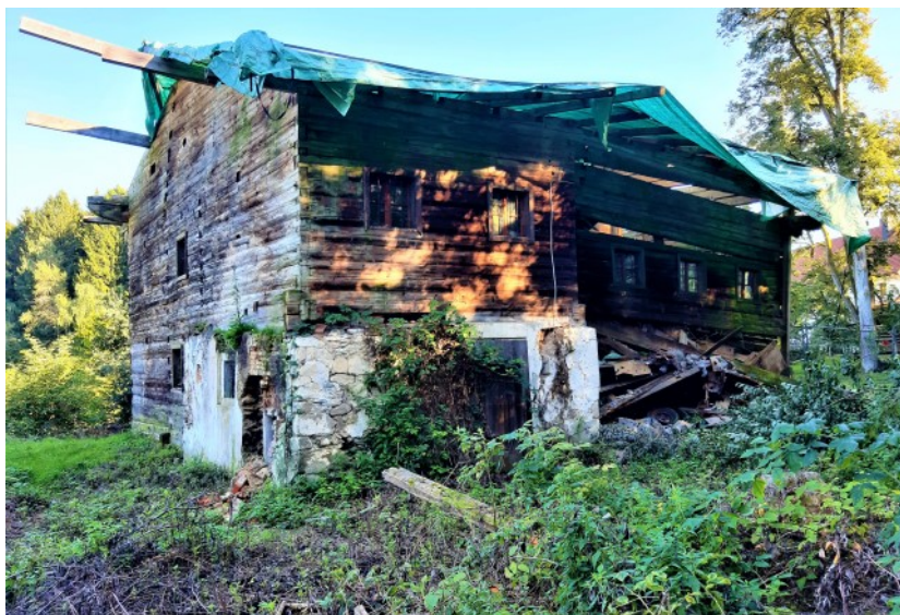
© (F. Jung) Notgesichertes Wohngebäude des 18. Jh.
