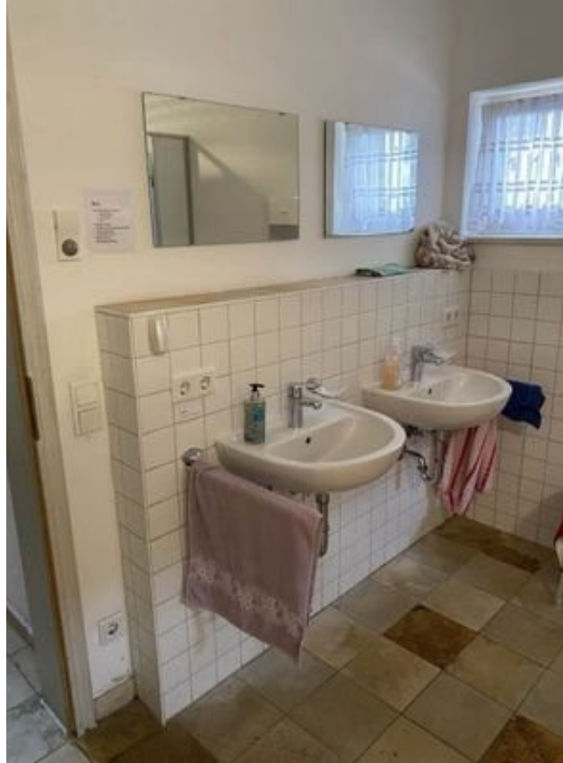
© (F. Mayr) Moderne Sanitäranlagen im EG
