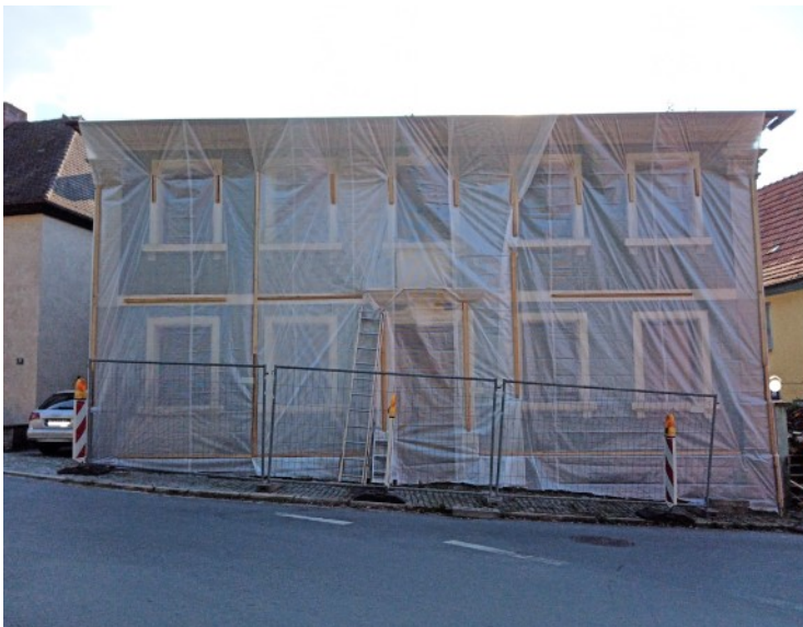
© (C. Huber) Historischer Altstadtbau mit notgesicherter Frontfassade
