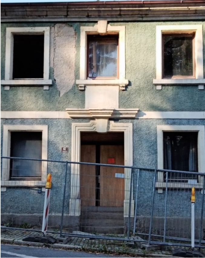
© (C. Huber) Gebäudezugang nach dem Brand
