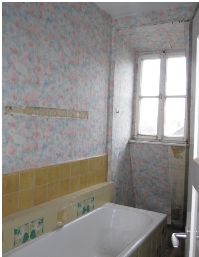
© (S. Hilpert) Renovierungsbedürftiges Badezimmer
