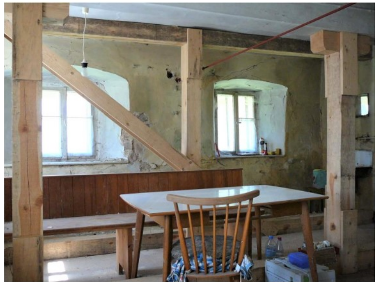
© (M. Beck) Derzeit notgesicherter Wohnraum im EG
