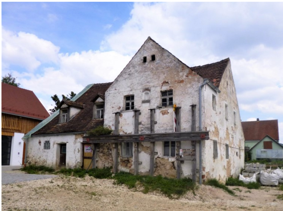
© (M. Beck) Sanierungsbedürftiges Wohnstallhaus im derzeitigen Zustand
