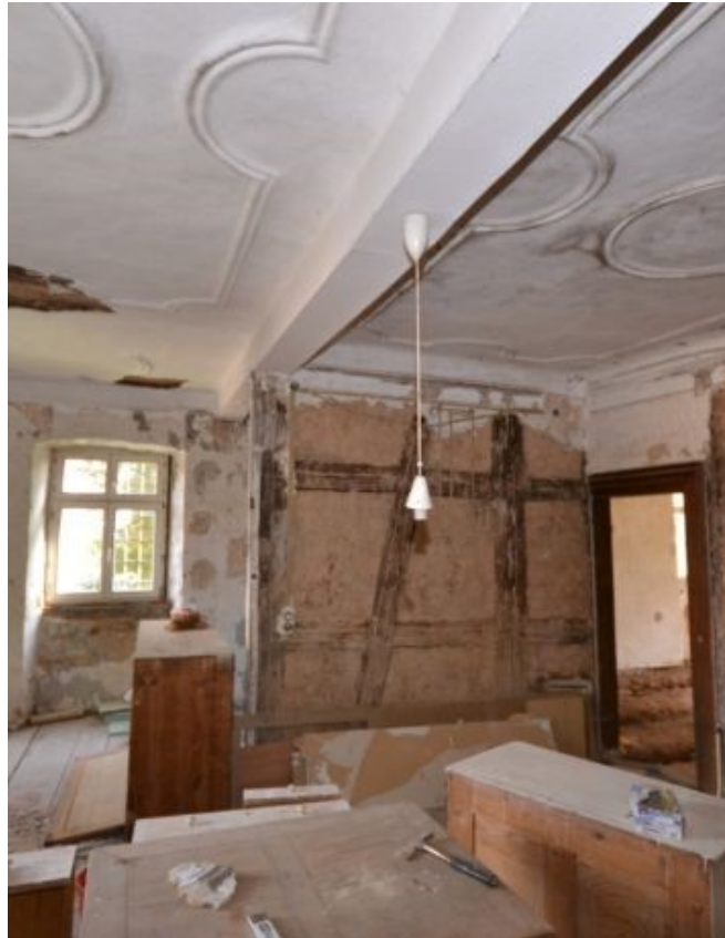
© (G. Gronauer) Sanierungsbedürftige Schlossräume
