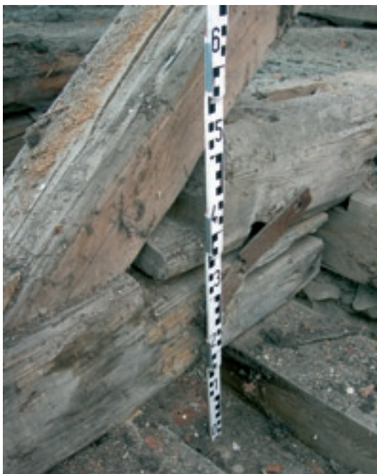
Dachwerk; Schadensbild am Zerrbalken
