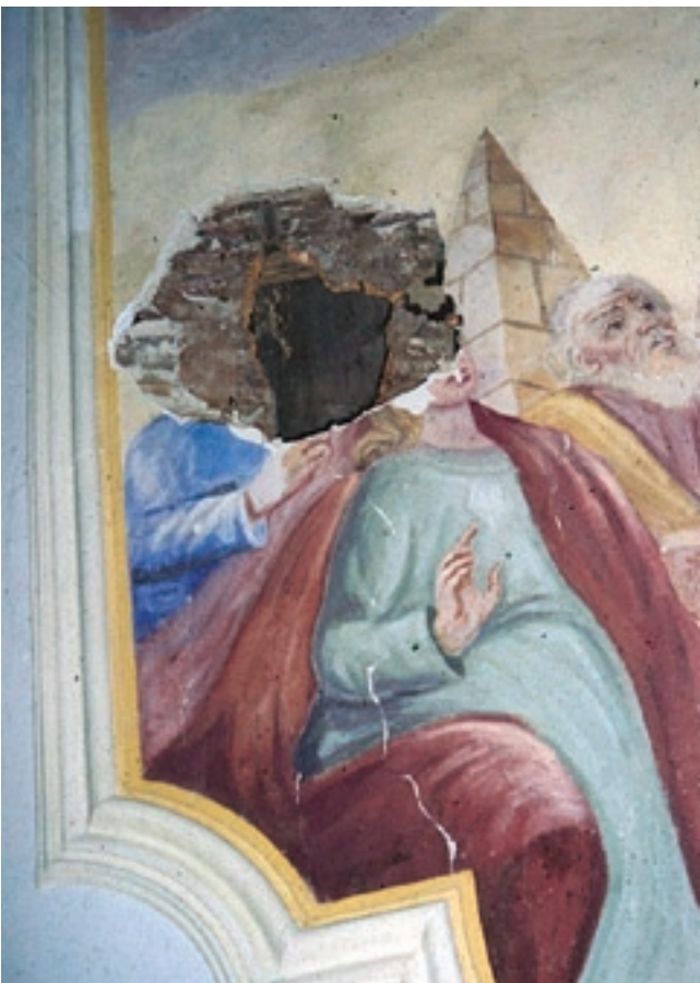
Deckenbild; historischer Bestand, unzureichend gesichert
