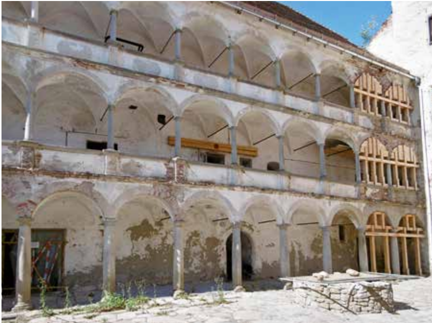
Westflügel mit hofseitigen Arkadengängen, Zustand nach Rückschnitt der Vegetation und Durchführung statischer Notsicherung, 2015
