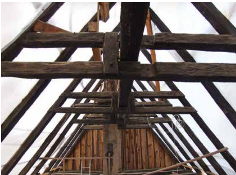
Königsfeld-Huppendorf, Huppendorf 26, Lkr. Bamberg. Kehlbalkenlage im zweiten Dachgeschoss. Die in jedem zweiten Gespärre angeblatteten Kehlbalken halten einen Mittelunterzug. Zusätzlich sind beide Kehlbalken mit kurzen Klammerhölzern seitlich des Unterzugs versehen. 1610/11 (d) (Foto: Georg Brütting, 2010)
