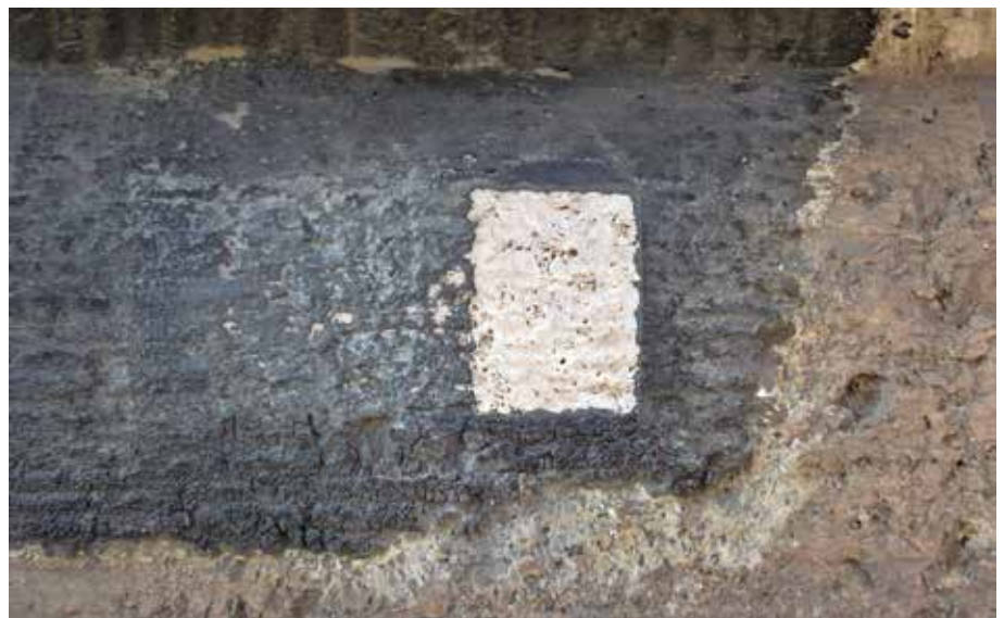
Frisches Reinigungsmuster innerhalb der schwarzen Schmutzkruste an der zur Oettingenstraße gelegenen Fassade des Neuen Studiengebäudes, 2014 (Foto: BLfD, Zentrallabor)
