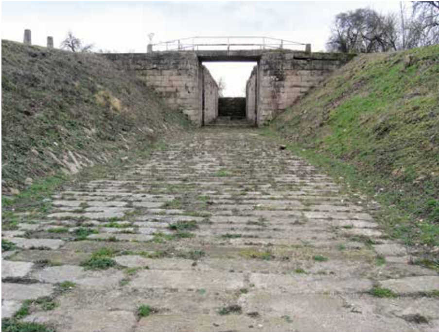
Schleuse 94, Ansicht von Norden vor Beginn der Restaurierungsarbeiten (Foto: BLfD, Robert Pick)
