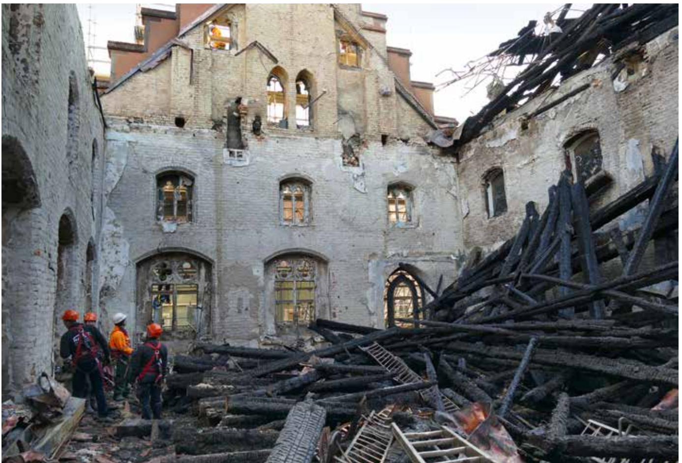
Straubing, Rathaus am 29. November 2016. Erste mögliche Begehung durch das BLfD mit der Feuerwehr. Der Rathausaal ist verloren (Foto: BLfD, Michael Schmidt)
